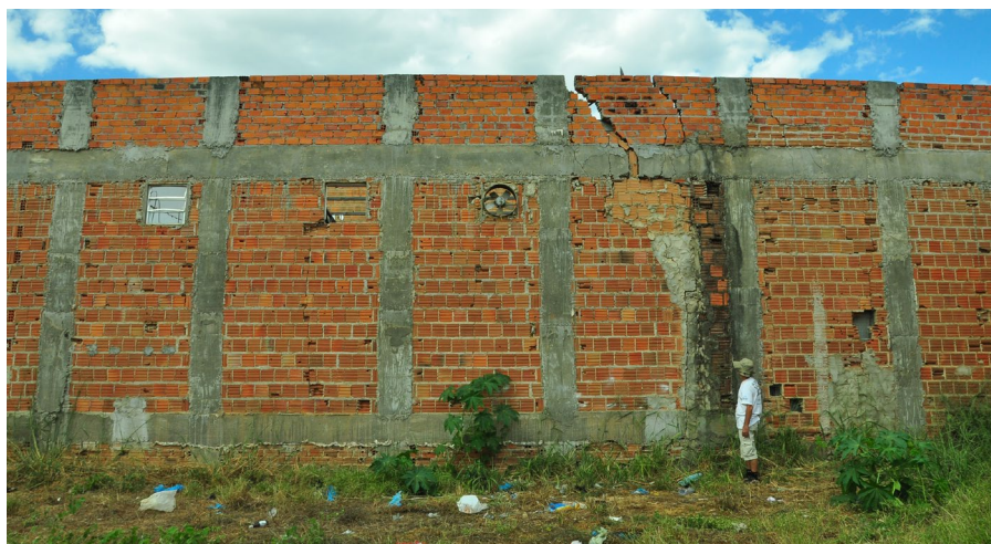
Parede com rachadura em construção abandonada, Lapão-BA.
