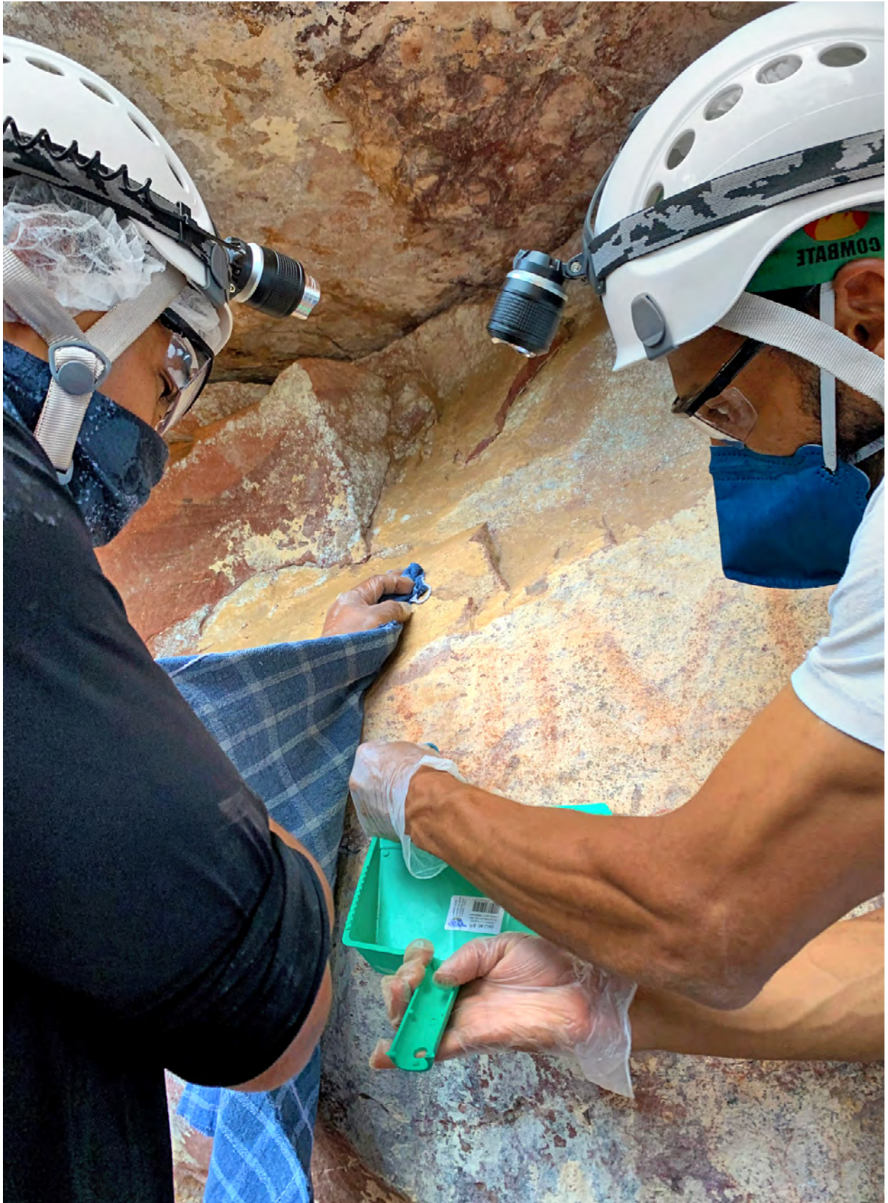
Curso Módulo 1 - Atividade prática de remoção de pichações, realizada na entrada principal da Gruta do Lapão, PARNA Chapada Diamantina, BA. foto: Luciana Alt.
