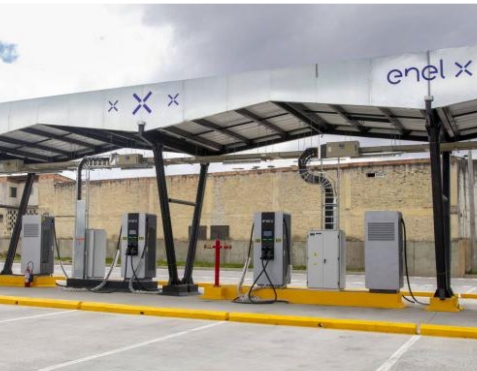
Figura 4-10 – Garagem adequada com infraestrutura de recarga em Bogotá
