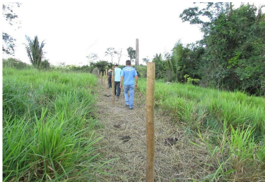
Figura 2 – Instalação de palanques de eucalipto doados pela prefeitura de Cotriguaçu (MT) para cercar uma APP em área de pastagem
