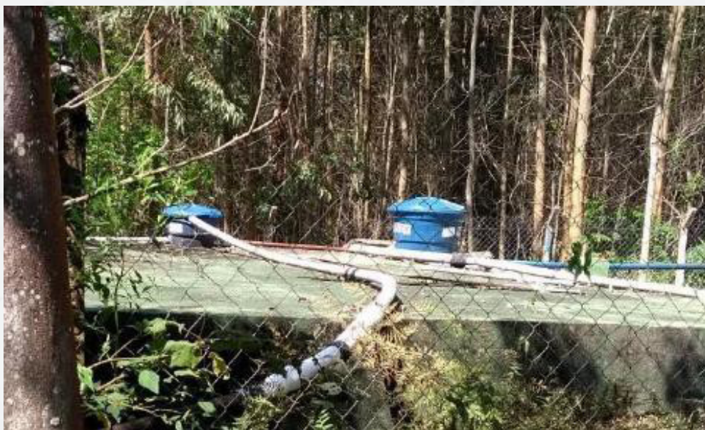
Figura 2 – Reservatório inicial da adutora.
