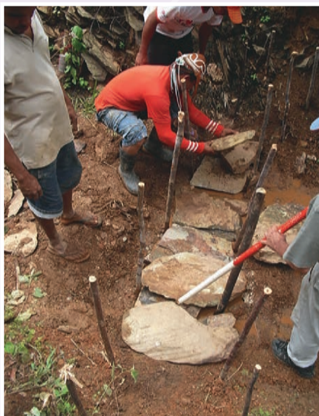
Foto 36.16 – Início da elevação do corpo da BBZ, em alvenaria de pedra seca. As pedras são dispostas no sentido longitudinal para funcionarem como cunhas, aumentando a estabilidade da obra, norma estabelecida por Arthur Padilha – ex-diretor do Dnocs – “o pai do Sistema BBZ”.
