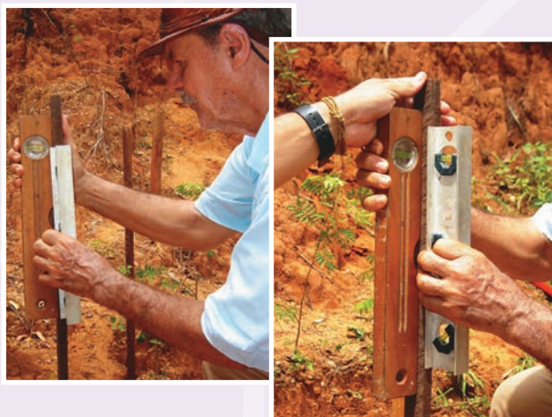
Fotos 22 e 23 – Verticalização das estacas dos arcos jusante e montante com auxílio de dois “níveis de pedreiro”.
