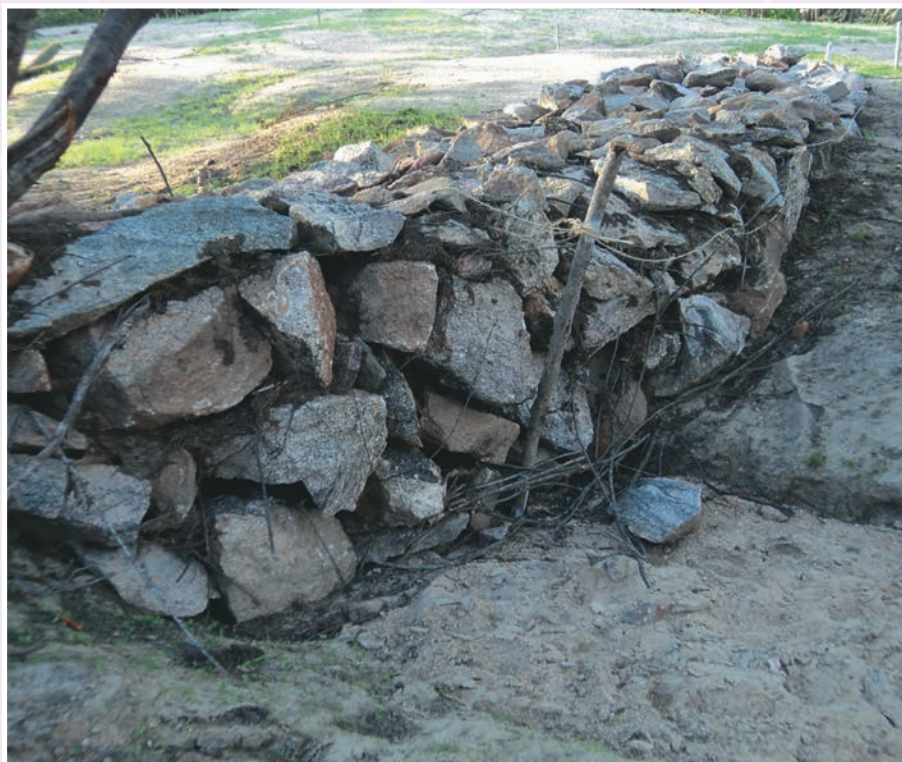
Foto 33 – BBZ concluída, vista da ombreira direita, a montante. Observa-se o seu coroamento nivelado pelo topo das estacas do arco montante e os interstícios para filtragem das águas turvas, retendo a montante o barro, a lama e o limo, formando as férteis minivazantes. O seu formato em Arco Romano transfere as pressões hidráulicas exercidas no barramento para as ombreiras dando a máxima estabilidade à obra, norma estabelecida por Arthur Padilha – ex-diretor do Dnocs – “o pai do Sistema BBZ”. Foto: Instituto Cactus
