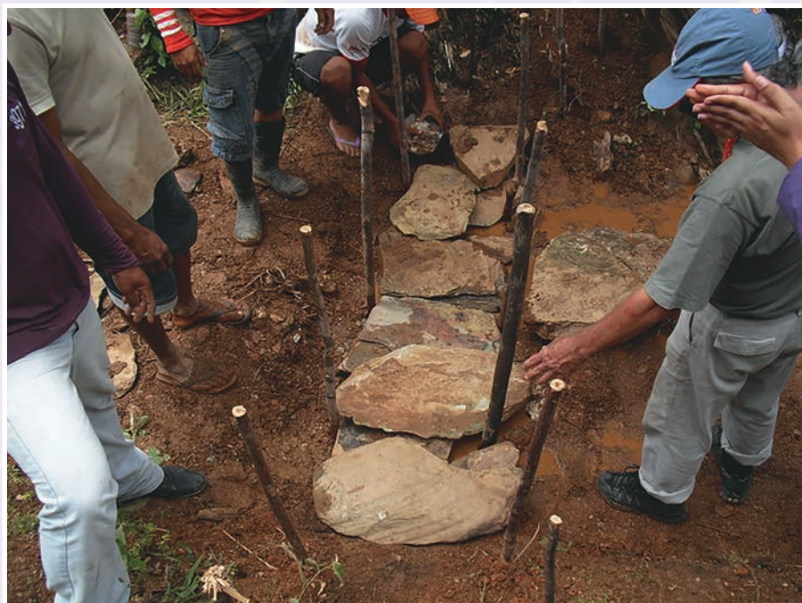
Foto 36.17 – Início da elevação do corpo da BBZ, em alvenaria de pedra seca, vista da ombreira direita. Observa-se o início da construção da mureta e do arraste da saia, orientado pelas estacas dos arcos montante e jusante.
