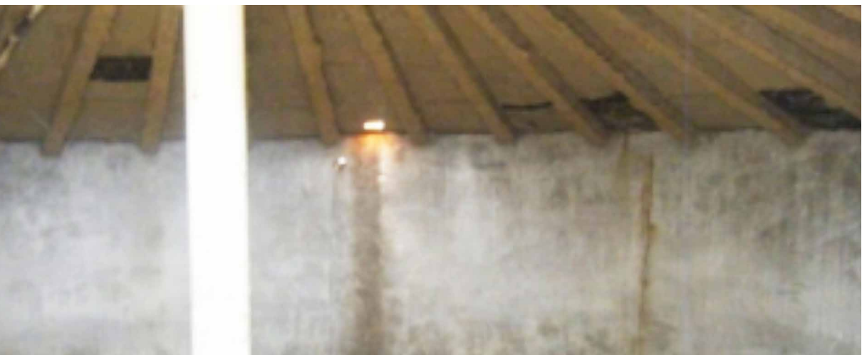
Figura 15 - Cisterna con falta de placas en su interior.
