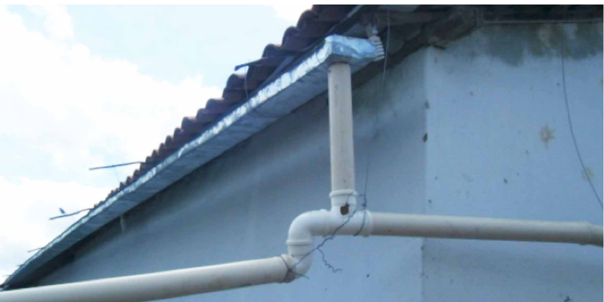
Figura 23 - Canalizaciones de recogida y transporte del agua de lluvia.
