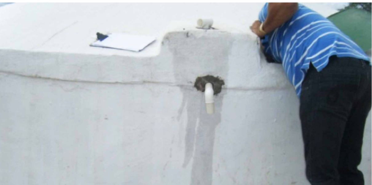
Figura 22 - Bomba manual en la que no se han pegado bien los tubos.
