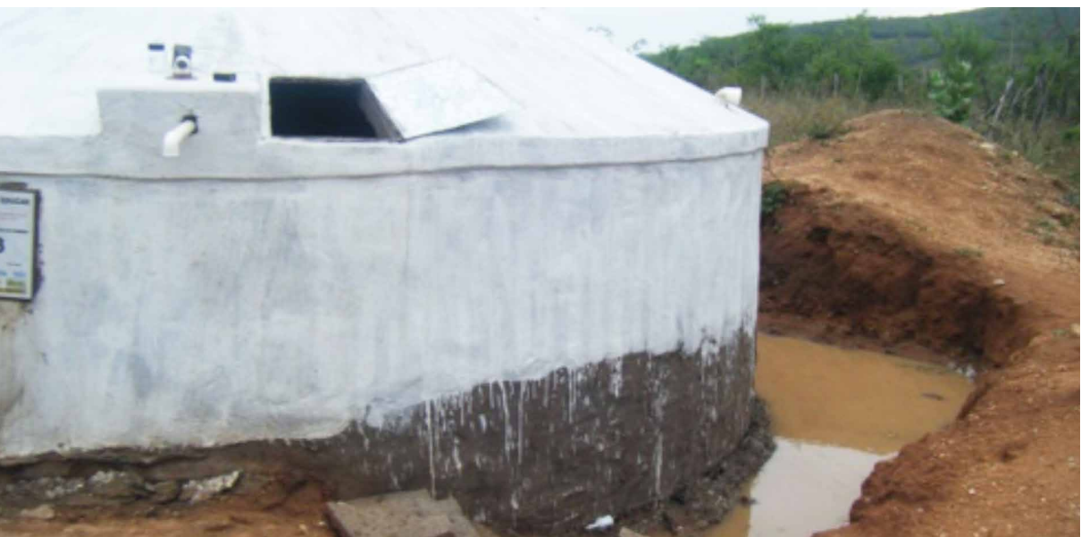
Figura 18 - Cisterna acabada en la que se ha formado un surco de agua por no recolectar la tierra.
