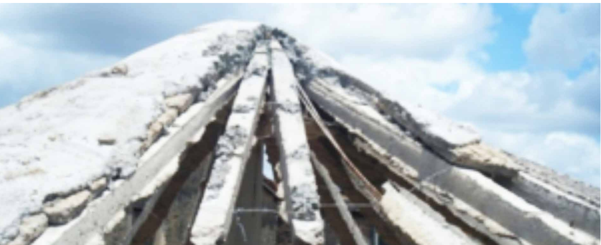
Figura 16 - Cisterna con rotura de viguetas.
