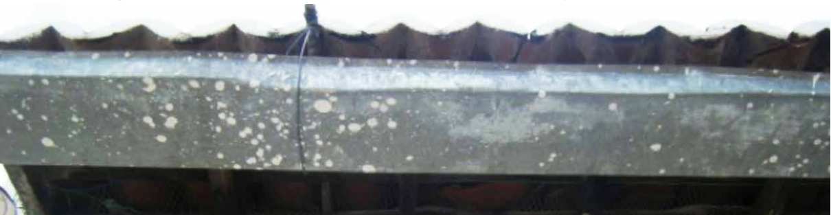
Figura 28 - Soportado de las canalizaciones horizontales en el tejado.
