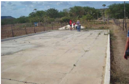
Figura 51 - Captação de água pluvial e armazenamento em cisterna.
