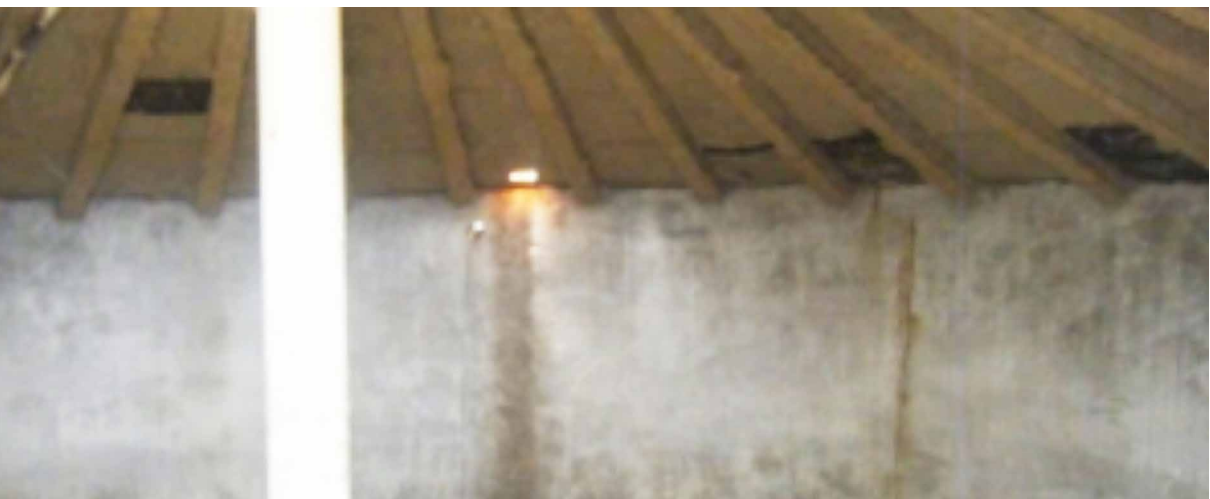
Figura 15 - Cisterna com falta de placas em seu interior.
