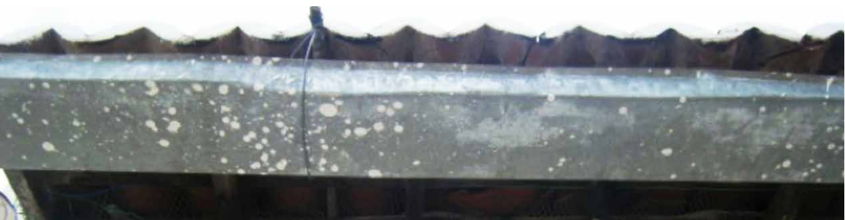
Figura 28 - Suporte das canalizações horizontais no telhado.
