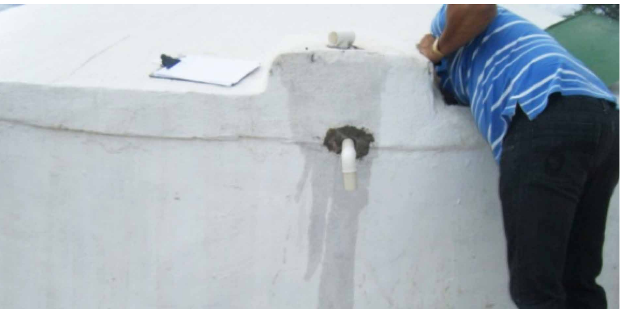
Figura 22 - Bomba manual na qual os tubos não foram fixados de modo adequado.
