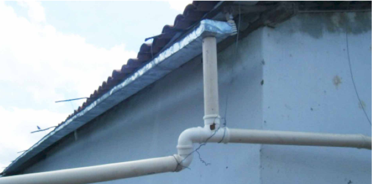
Figura 23 - Canalizações de coleta e transporte de água de chuva.
