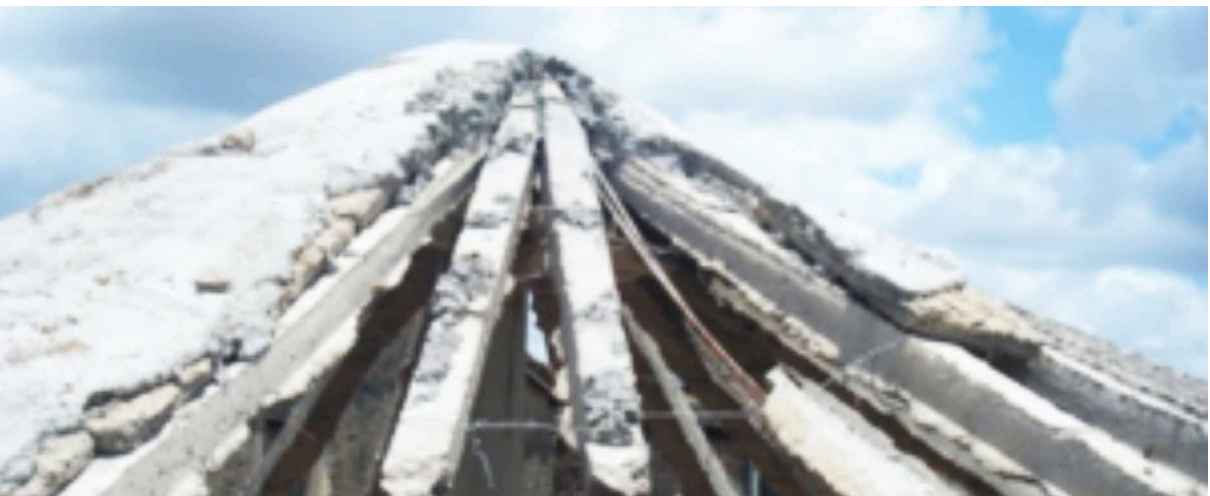
Figura 16 - Cisterna com fraturas de vigas.
