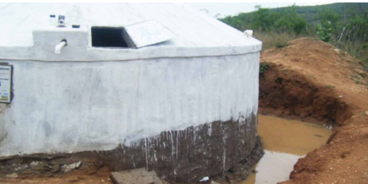
Figura 18 - Cisterna concluída na qual se formou um sulco de água por causa da terra não recolocada.
