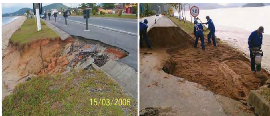
Figura 3 – Erosão decorrente na praia de Massaguaçu e início das obras do muro de contenção
