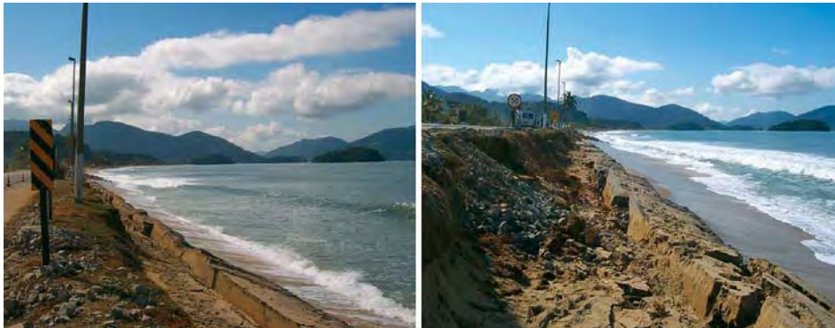
Figura 6 – Solapamento do muro de contenção em 2006
